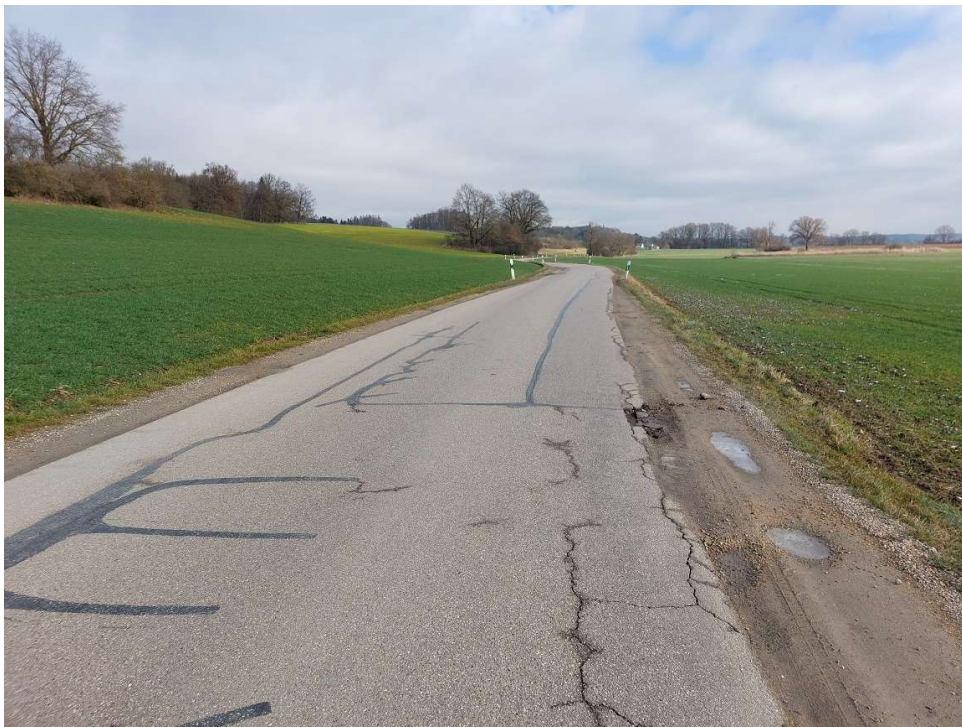
Situation vor der Sanierung – Der Straßenkörper ist bereits stark in Mitleidenschaft gezogen
